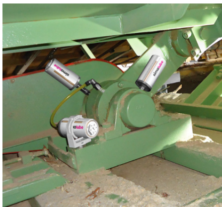
Lagren på en vibrationsmatare smörjs kontinuerligt av tre lubrikatorer.
