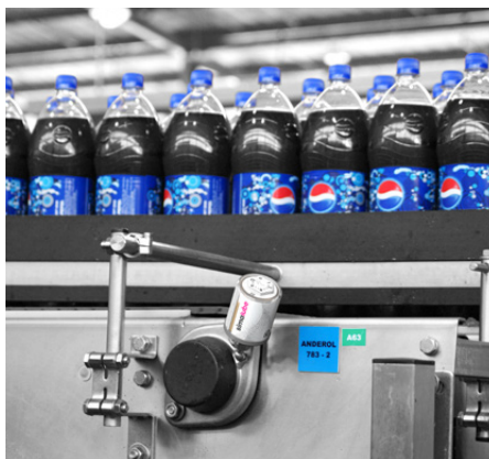
Smörjning av ett flänslagerhus på en tappningsmaskin för läsk.
